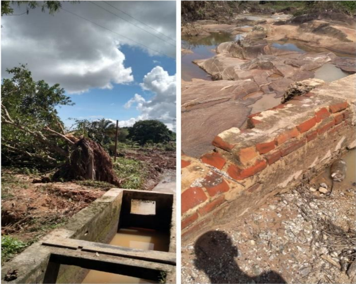
Figura 6(a) 6(b) — falta de manutenção
