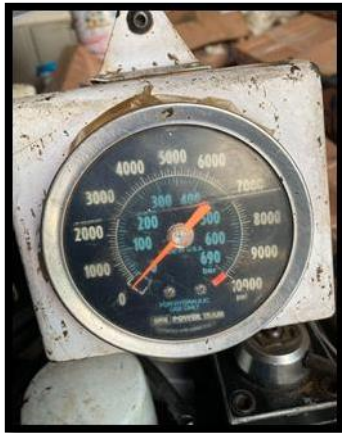
Figura 3: Manômetro da bomba.
