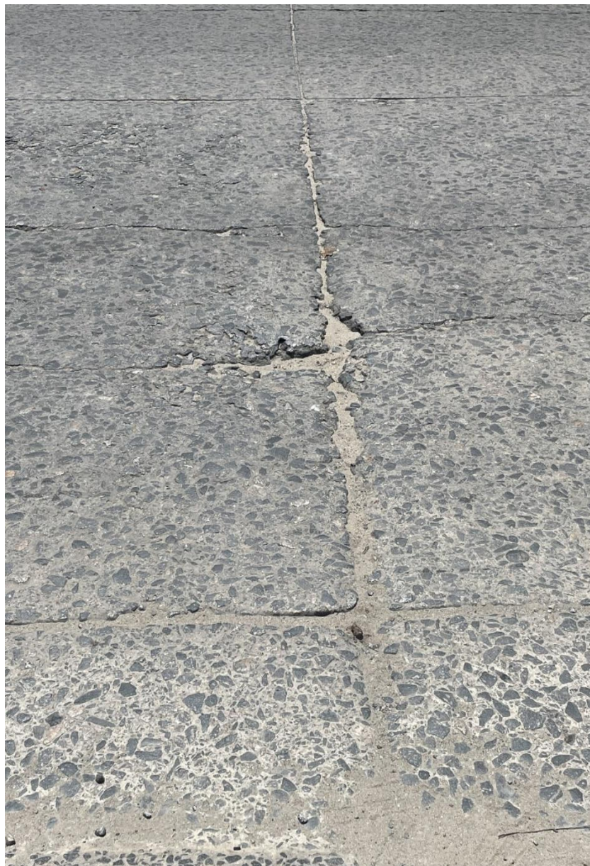
Figura 10: Quebras de canto e Falha na selagem
