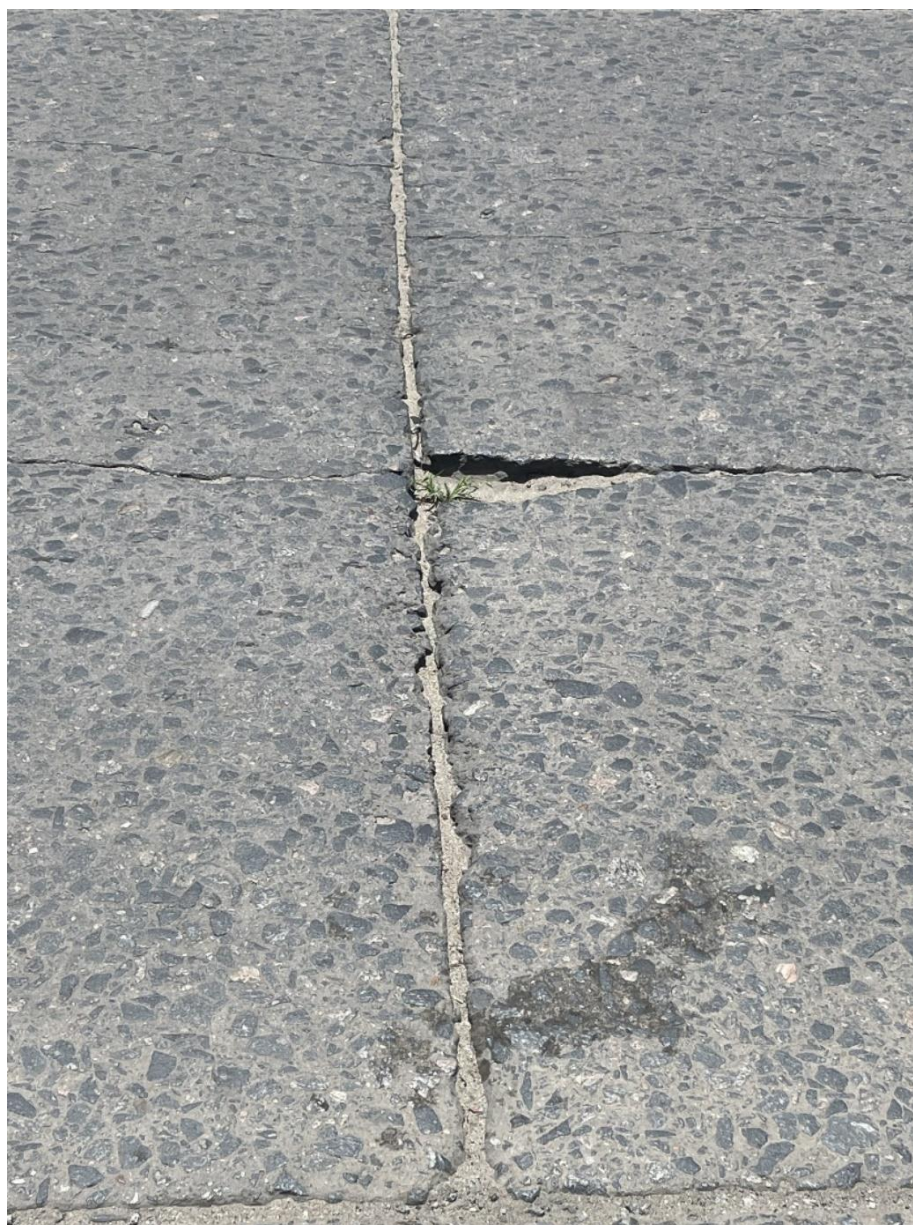
Figura 11: Quebras de canto e Falha na selagem
