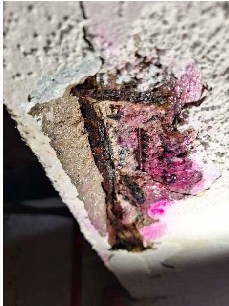
Figura 17 – Armaduras apresentando avanço de corrosão e estrutura possuindo frente de avanço em carbonatação
