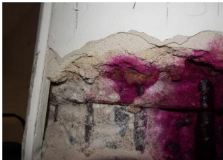
Figura 10 – Trecho ensaio com grande presença de carbonatação na estrutura já apresentando corrosão progressiva das armaduras
