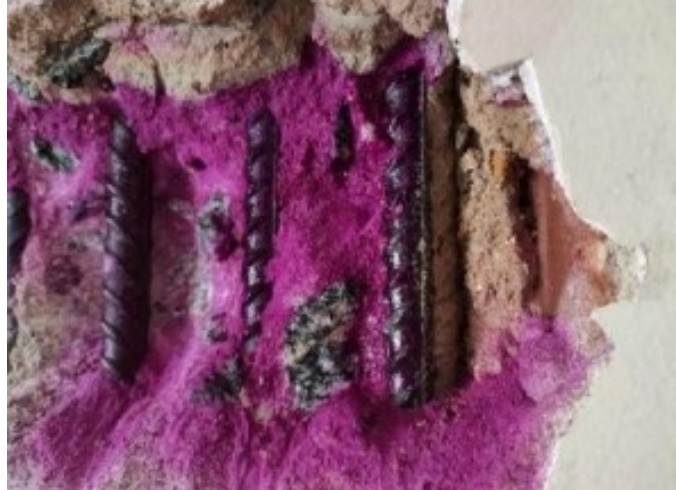
Figura 9 – Área com presença mínima de carbonatação identificada
