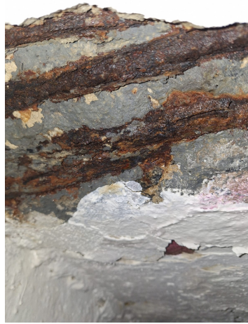
Figura 19 – Armaduras com alto grau de corrosão sem nenhum tipo de tratamento e frente de deterioração constante
