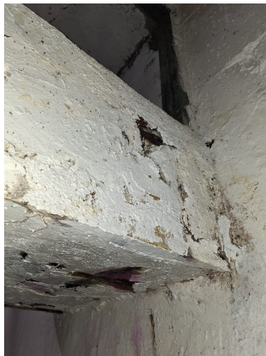
Figura 18 – Áreas com grande carbonatação em trechos totalmente expostos na estrutura de concreto armado
