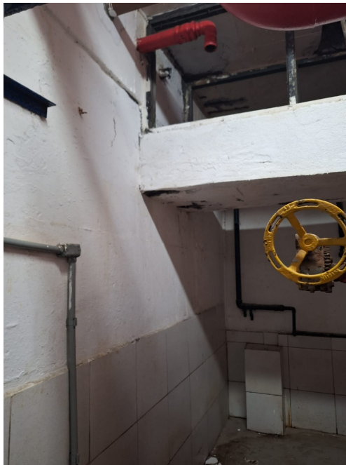
Figura 16 – Local com pontos visíveis de deterioração e infiltração que se estendem por todo o local
