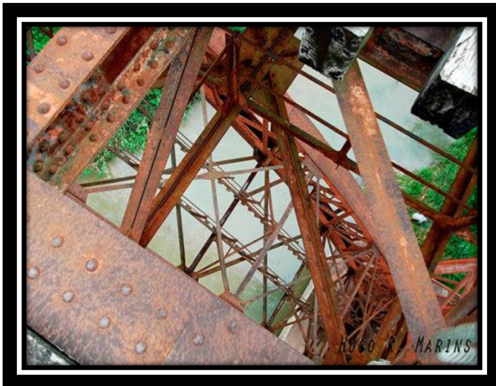
Figura 12: Estrutura em processo de corrosão
