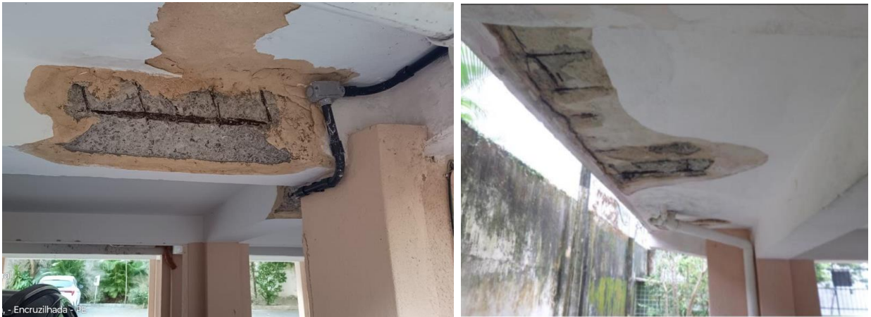
Figura 10 – Elementos de estrutura (laje/viga) apresentando desprendimento de revestimentos, ferragens expostas e oxidadas com redução de seção em alguns trechos.
