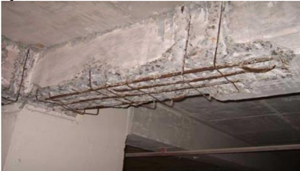
Figura 5 – Corrosão da armadura
