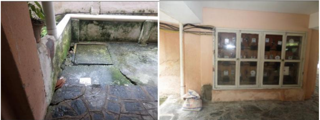
Figura 9 – Afundamento de piso junto a caixas de inspeção e quadro de energia com porta danificada
