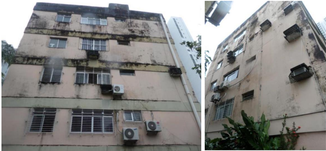
Figura 8 – Fachada do edifício apresentando pintura envelhecida, manchas de infiltração
