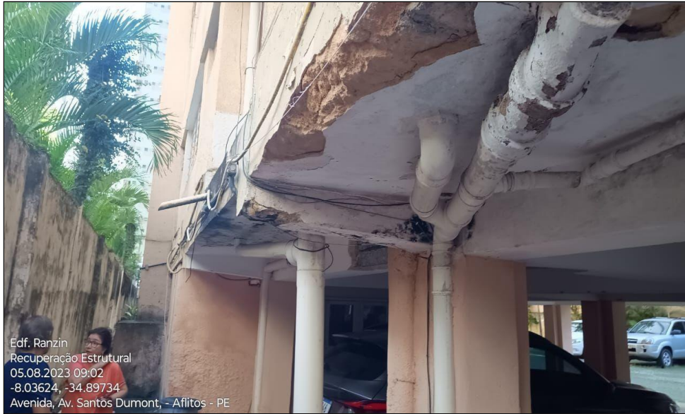
Figura 13 – Deterioração do concreto
