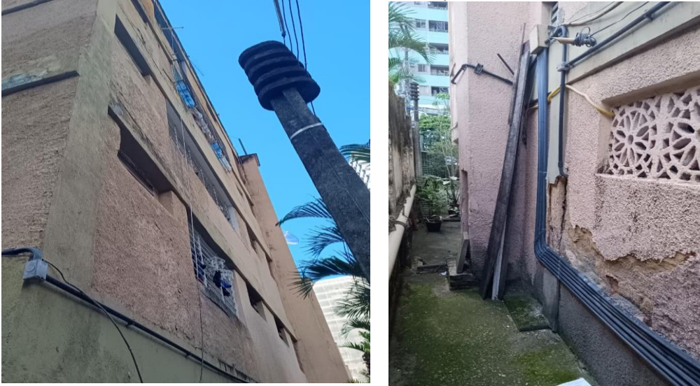
Figura 11 – Fachada apresentando rachaduras e desprendimentos de revestimentos
