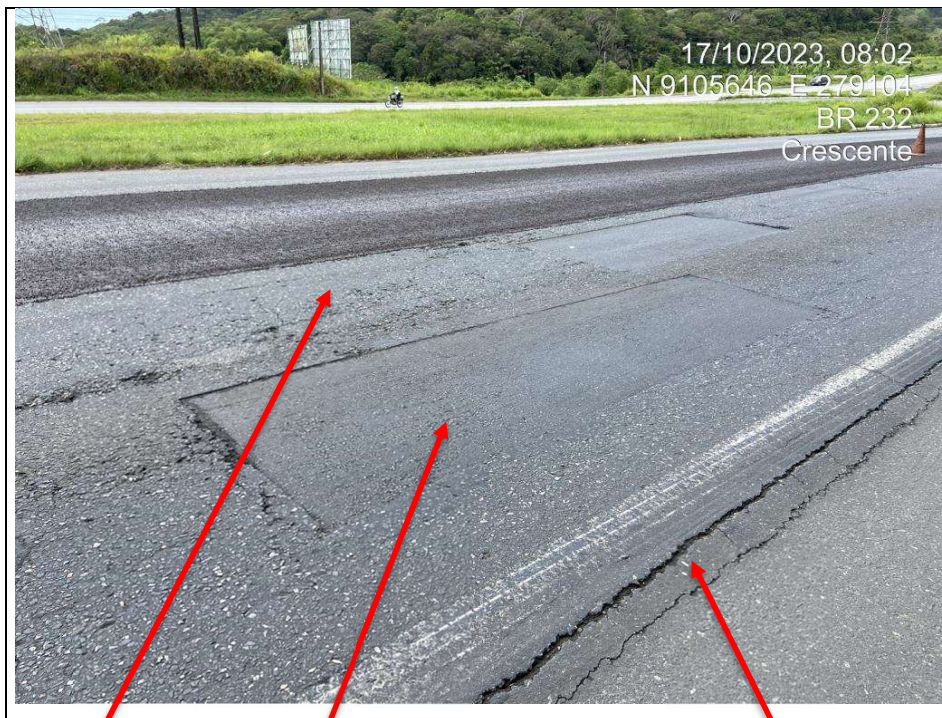
Figura 5 – Remendo Superficial, Trincas Isoladas, Desgaste do Pavimento
