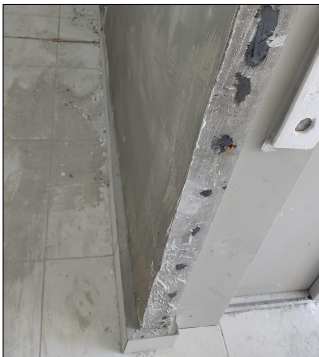
Figura 26 - Possível deformidade ocasionada pela reutilização das fôrmas metálicas
