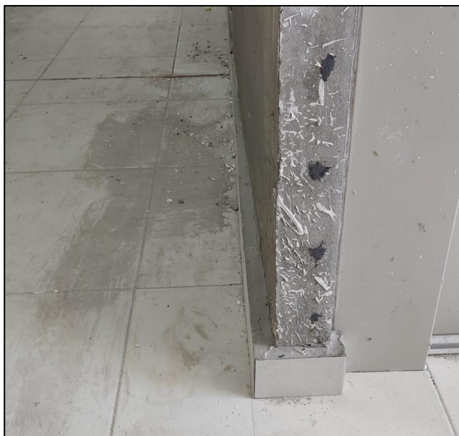
Figura 30 - Possível deformidade ocasionada pela reutilização das fôrmas metálicas
