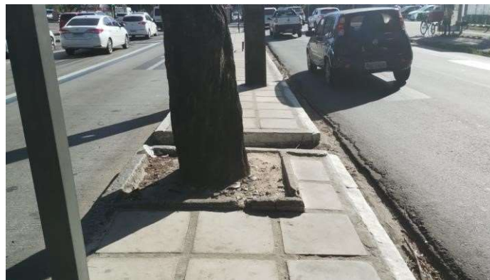
Figura 28 – Continuidade de calçada imprópria para cadeirante
