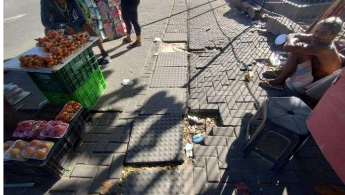
Figura 27 – Piso com Irregularidades
