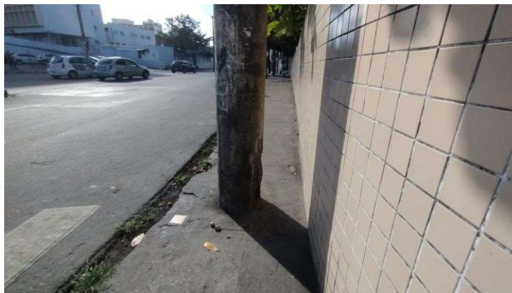
Figura 29 – Poste de concreto servindo como obstáculo
