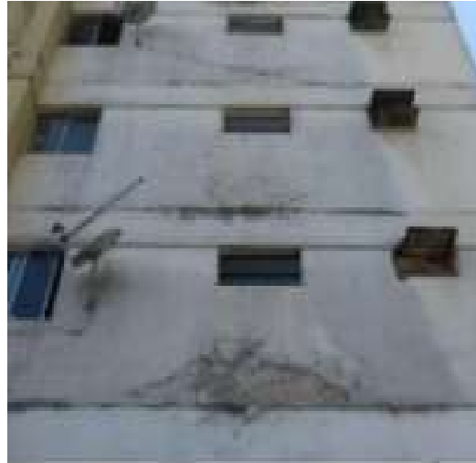
Figura 4: mostra manchas por infiltração; ( fonte autores 2022)
