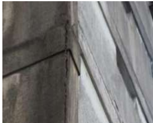
Figura 6 Presença de fissura na fachada (fonte autores 2022)
