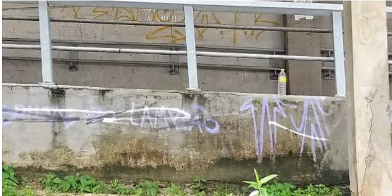
Figura 2 – Corrimão da rampa de acesso da estação do metrô
