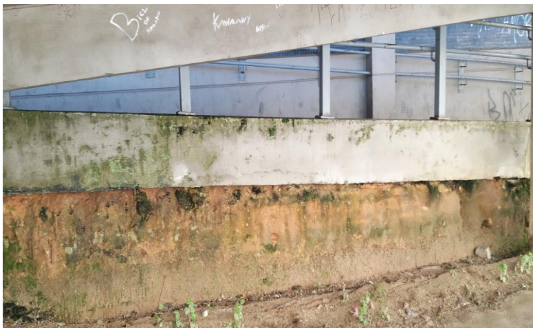
Figura 3 – Abertura por fuga de material embaixo da viga do corrimão
