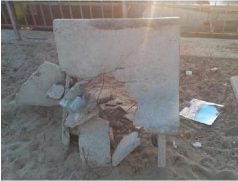
Figura 84 – Banco de concreto.
