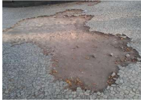
Figura 91 – Ausência da manutenção.
