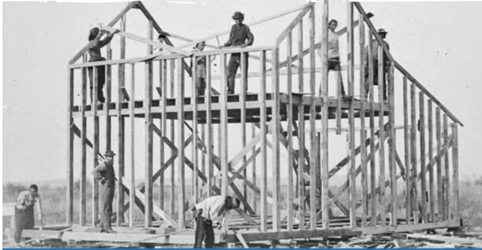
Estrutura de hood frame Fonte : Decorlit (2019)
