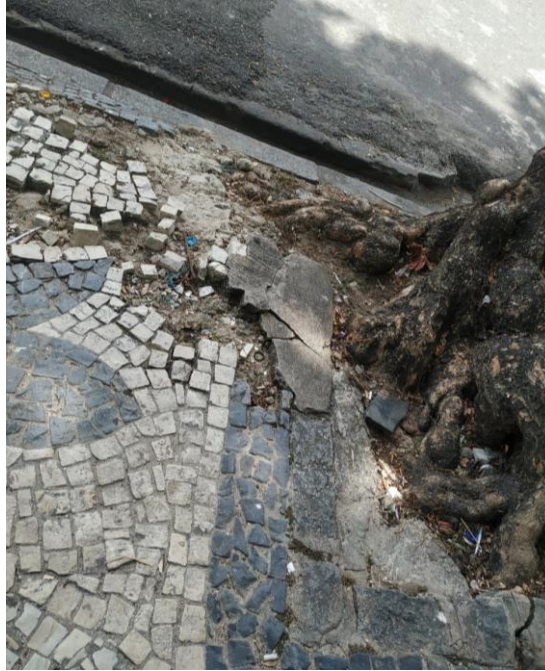
Figura 25: Calçadas danificadas, Avenida Alfredo Lisboa (1).
